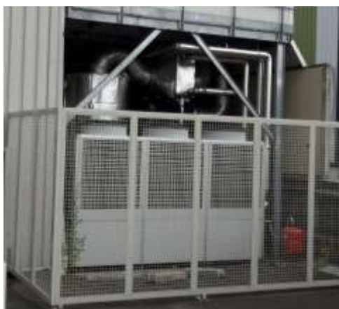
Echangeur cyclonique et batterie de restitution de la chaleur
